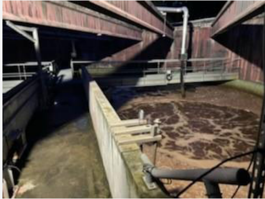
Bassin d'aération B9
